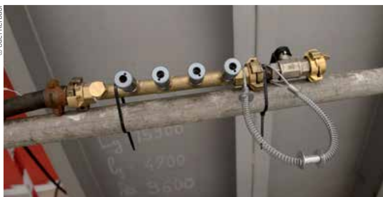
(Rampe pour alimentation en air comprimé)
